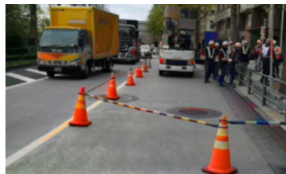
写真2 立ち入り禁止措置
